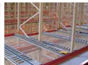
Abgitterung zwischen doppelten Rollenbahnen; manuell bedienbarer Separator.
